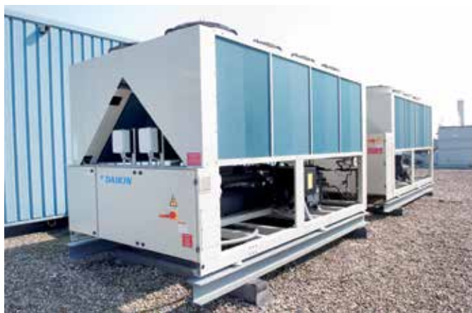
Установленная холодильная машина с воздушным охлаждением конденсатора
