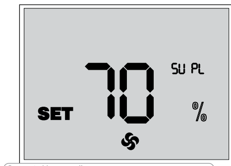
Рис. 13. Настройка скорости вентиляторов
